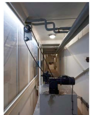
024_VT_Copyright_david_zidlicky_STROJOVNA PRO ELEKTRICKÝ SPOUŠTĚNÍ OKNA.jpg
