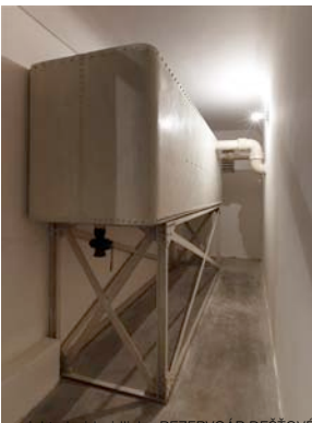
025_VT_Copyright_david_zidlicky_REZERVOAR DEŠTOVE VODY.jpg
