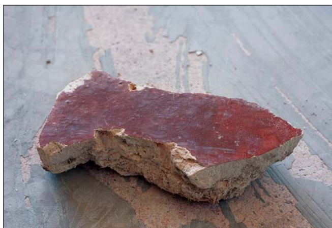
Obr. 3: Vila Tugendhat: a – řez vrstvou Sorelova cementu (vlevo), který se dochoval pod onyxovou přičkou v hlavním obytném prostoru (2. NP), vpravo ocelový nosný prvek vynášející tuto přičku; b – fragment Sorelova cementu s červeným tvrdým povrchem, který byl vyjmut ze zdiva za knihovnou v hlavním obytném prostoru (2. NP).
