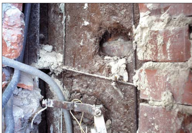
Obr. 4: Vila Tugendhat: a – izolační desky zn. Torfoleum ve zdivu v někdejším pokoji kuchařky v personálním traktu (2. NP); b – detail izolace zn. Torfoleum u ocelového nosného sloupu (vlevo).
