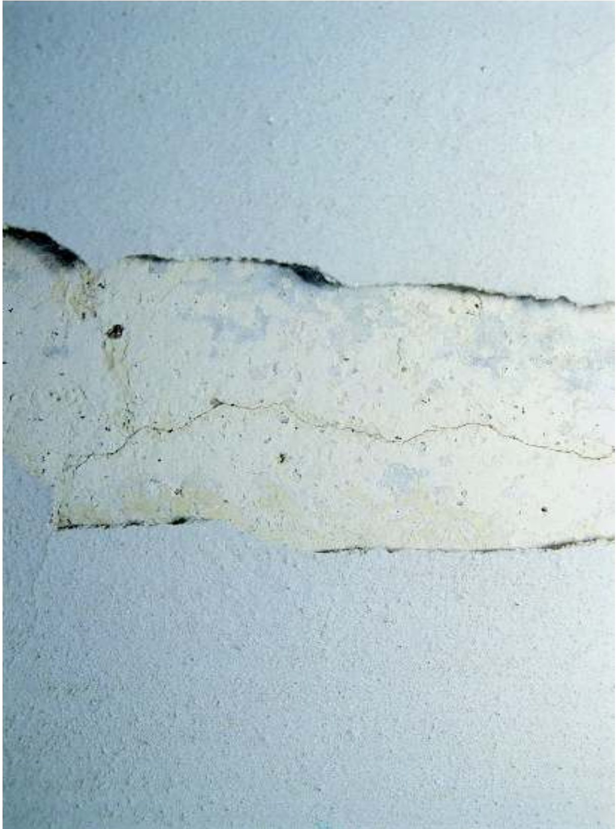
Farbabb. 18: Haus Tugendhat, Flanke der Außentreppe, Detail: Unter den Schäden des rezenten Verputzes und Kunstharz-Anstriches der Renovierung von 1981-85 findet man die ursprüngliche steinfarbige gelblich-weiße (Kalk-?) Oberfläche mit Resten von Reparatur-Anstrichen: Grau und Ockergelb.
