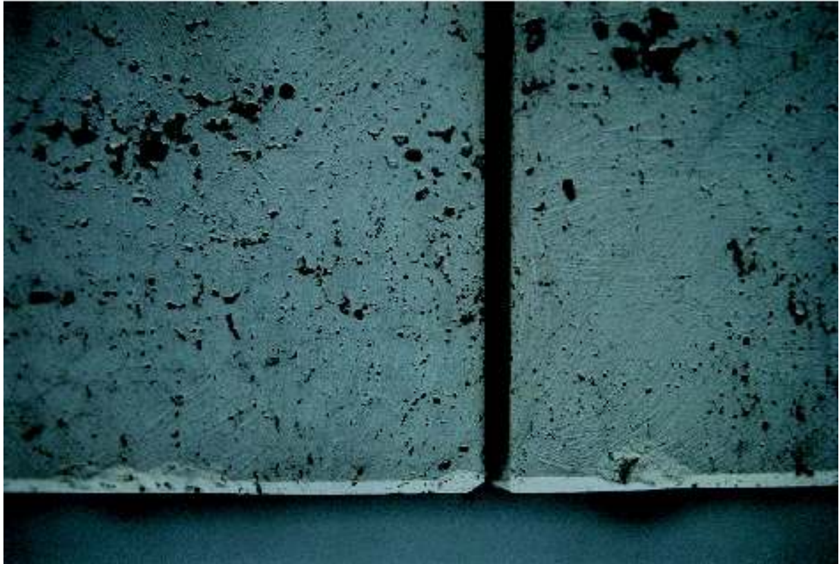
Farbabb. 16: Haus Tugendhat, obere Terrasse, Abdeckung der Brüstung mit Travertinstein, Schleifspuren der Renovierung von 1981-85. Foto: Ivo Hammer ca. 1990.
