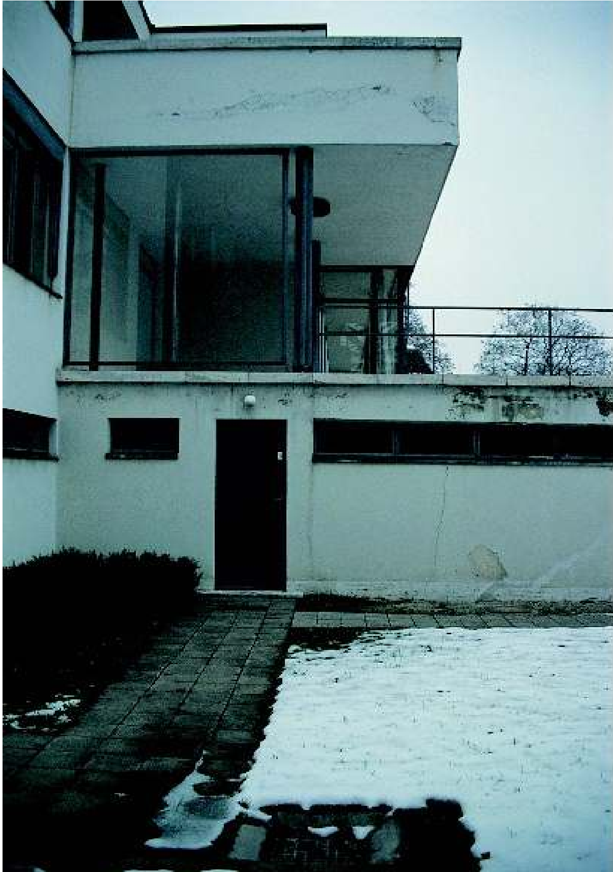
Farbabb. 19: Haus Tugendhat, Ansicht von Westen. Statische Risse und Schäden in Verputz und Anstrich. Foto: Ivo Hammer 1997.
